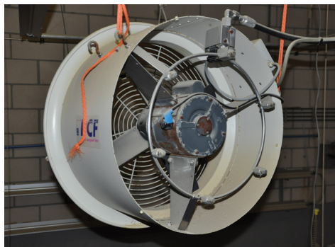
Nevelkoeling met recirculatieventilator
