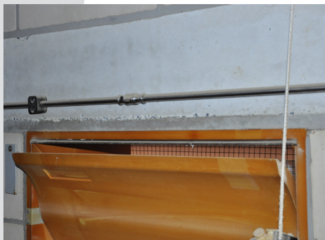
Nevelkoeling aan de inlaatventielen
