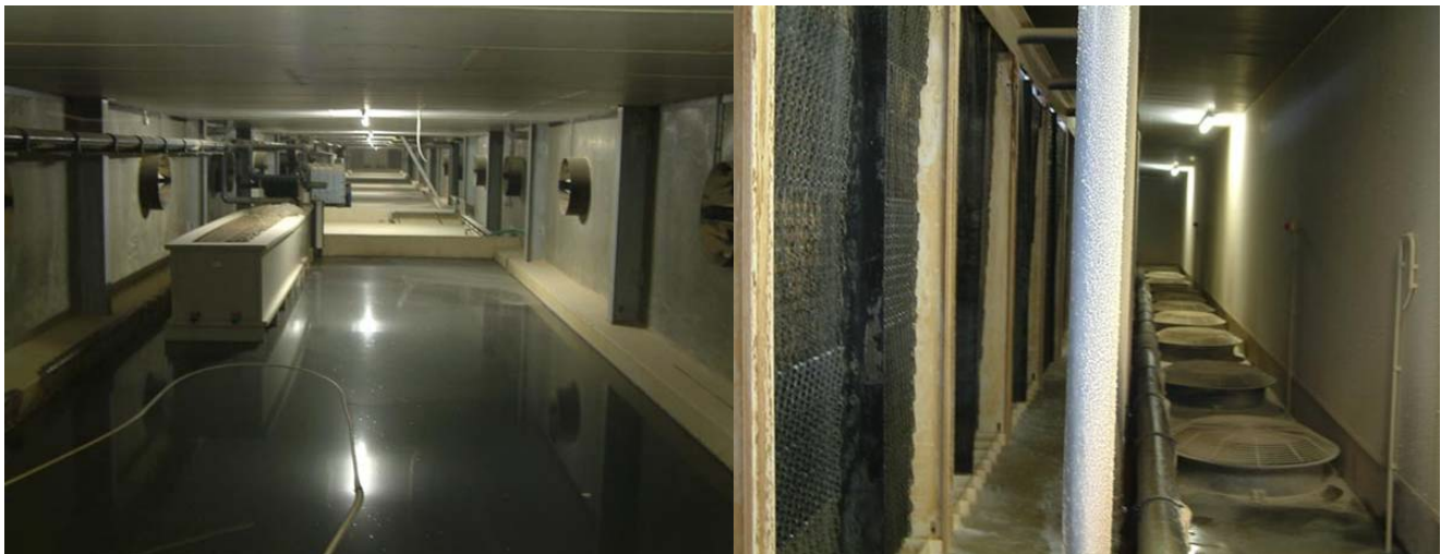
Figuur 17 Biologische luchtwasser in een TerraSea stal (zie verder): links het centraal kanaal, rechts het vulmateriaal van de wasser (Bron: Boerderij)
