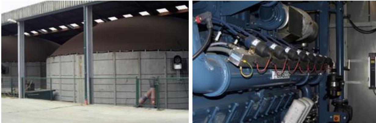
Figuur 60. De biogasinstallatie van Biofer bvba
